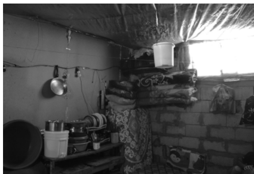
倉庫を改造したシェルター。隙間から雨水だけでなく蛇やネズミが入ってくる。窓にはガラスが無く、冬は凍死の危険がある
